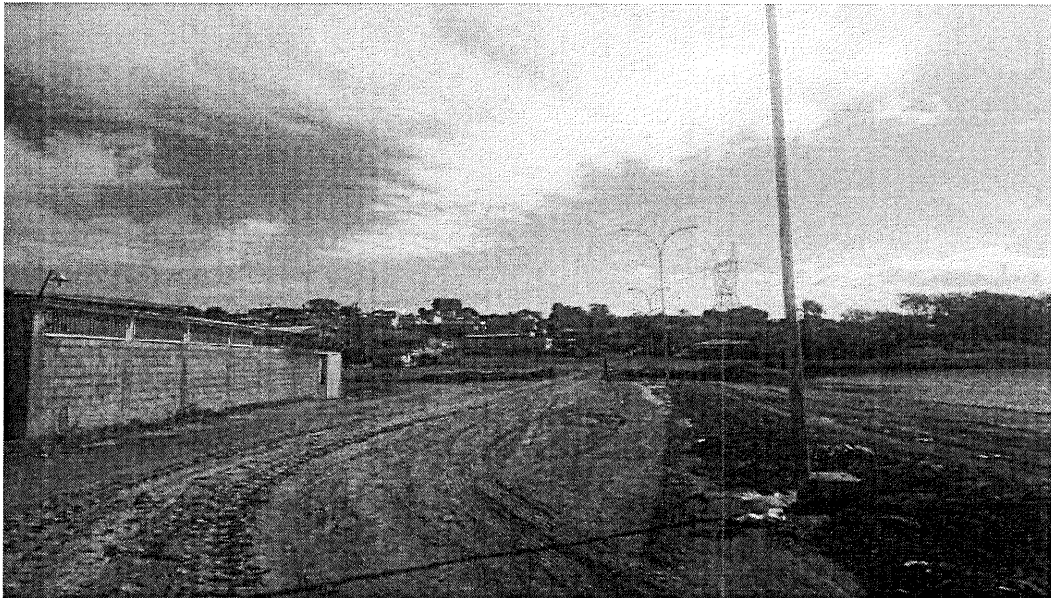
Foto 01: Trecho da Avenida Copacabana, para execução do calçamento do pavimento intertravado sextavado.
